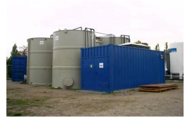
Grundwassersanierungsanlage in Erkner, bei Berlin
