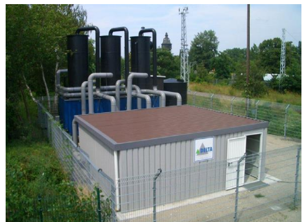
GWRA mit Strippkolonnen
